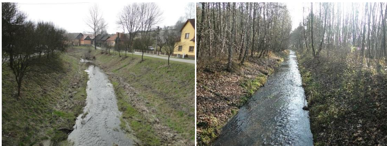
Obr. 37: Koryto je nadměrně zahloubené (vlivem technické úpravy) – intravilán (vlevo), extravilán (vpravo)
