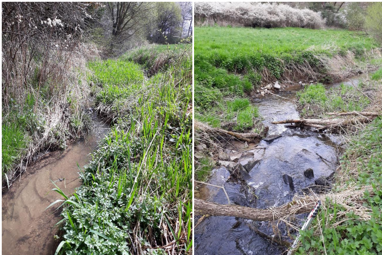
Obr. 29: Působení renaturačních procesů – sesouvání břehů do koryta, rozvolňování trasy, překrytí úpravy dna (vegetační tvárnice) sedimenty a vznik akumulčních tvarů (vlevo), uvolnění a odnos opevnění koryta betonovými prefabrikáty, vznik nátrží, rozvolňování trasy vymíláním do stran (vpravo)
