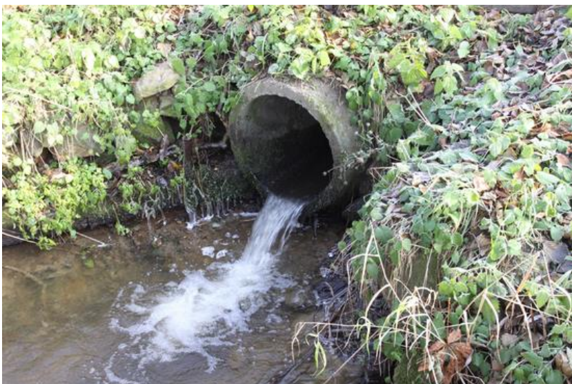
Obr. 46: Propustek vyústěný nad hladinou vody představuje úplnou protiproudovou migrační bariéru pro všechny druhy ryb.
